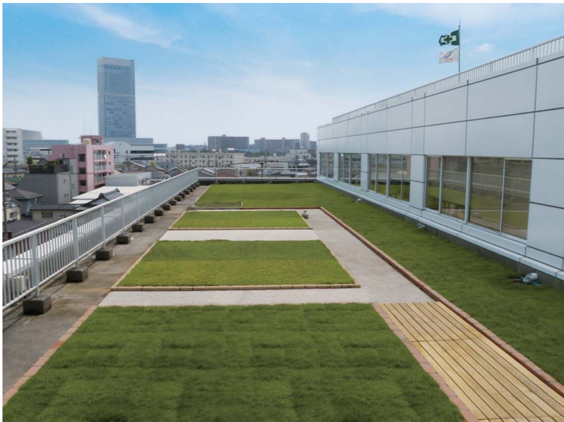
屋上緑化風景
