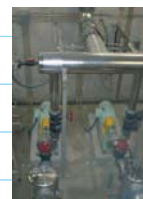
● 取水ポンプ室内部
