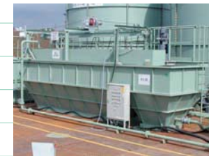
濁水処理施設
